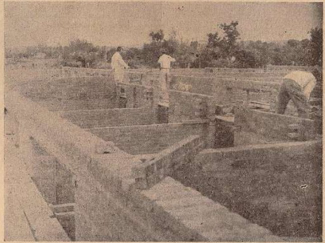
As obras do Sanatório Allan Kardec, em Presidente Prudente, no dia 15 de abril de 1962. Atualmente essa importante obra de assistência social erguida pela AREA — Associação Regional Espírita de Assistência da 25.ª Região, está com o telhado praticamente terminado.
